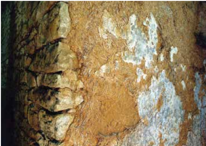
Fig. 1 : Enduit de terre d'un mur en pierre du xvii^e siècle. Čistá n° 186, distr. Svitavy (J. Škabrada).
